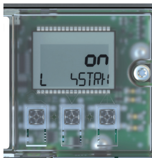
nastavení signalizace alarmu pro údržbu
